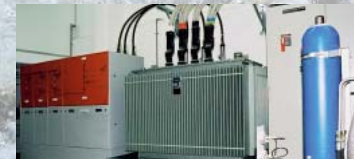
Mittelspannungsanlage und Transformator, Hydraulikaggregat
