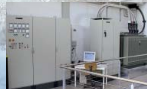
Steuerung, Leistungsschalterschrank und Transformator
