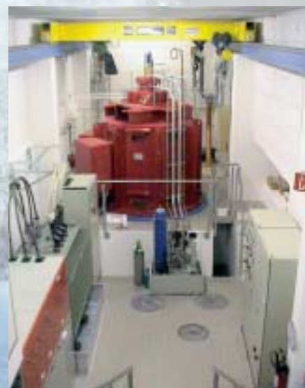
Maschinenhaus mit Generator (rot) und Kran (gelb)
